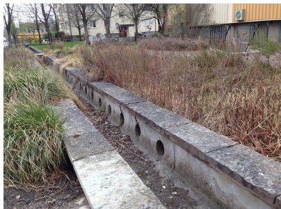
Bild 5: Dagvattenkanal i Augustenborg med möjlighet genom hål att fylla upp intilliggande växtbäddar. (Malmö/ Pernilla Rudin)
